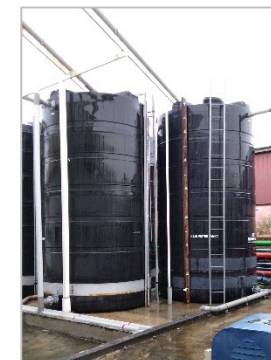
SMMの雨水タンク
